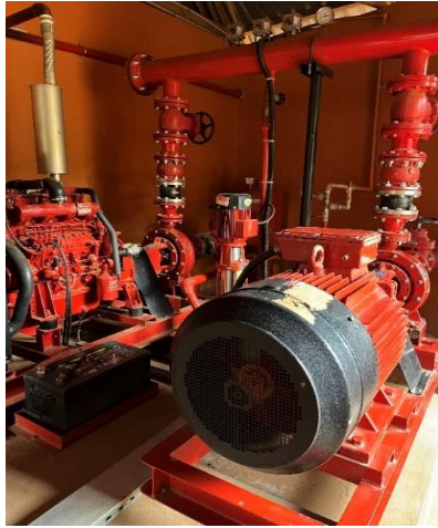
〔日本が供与した消火装置〕
