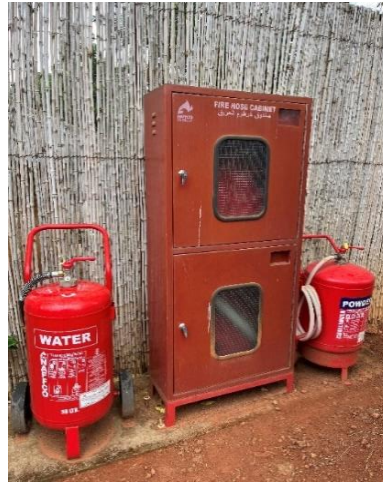
〔日本が供与した消火ポンプ〕
